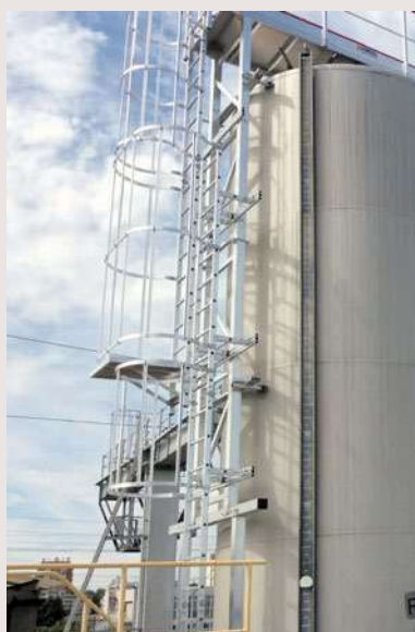
Échelle à crinoline sur silos de stockage pétrochimique
