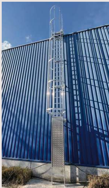
Échelle à crinoline avec porte de condamnation d'accès basse
