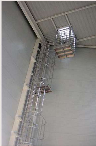
Échelle à crinoline intérieure pour accès en toiture
