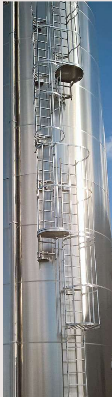
Échelle à crinoline sur cuve de stockage
