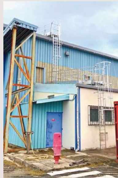
Échelles à crinoline et passerelles sur toitures
