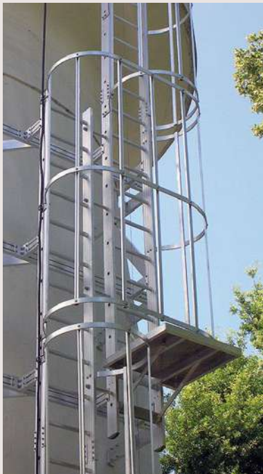
Échelle à crinoline montant renforcé pour accès en toiture d'un château d'eau
