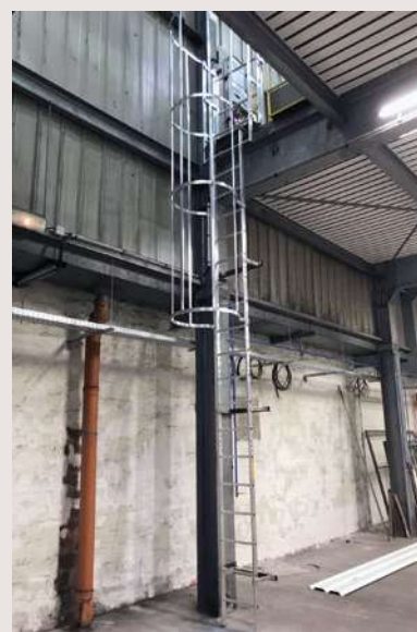
Échelle à crinoline en intérieur
