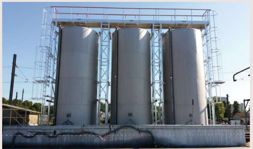
Échelles à crinoline avec passerelle sur silos pétrochimiques
