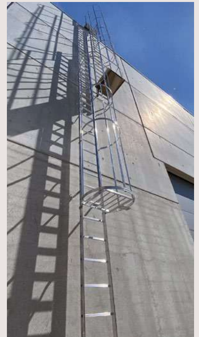
Échelle à crinoline avec changement de volée et condamnation basse
